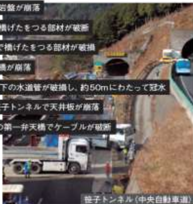
図1 トンネルが崩れ、橋が切れる 日本全国のトンネルや橋が壊れる事故が相次いでいる。主な原因はインフラの老朽化。(写真：第一弁天橋は国土交通省中部地方整備局、笹子トンネルは日経コンストラクション)
