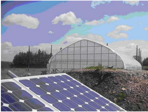
太陽光パネル設備
