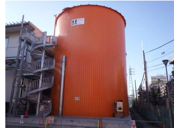
バイオガス発生タンク
