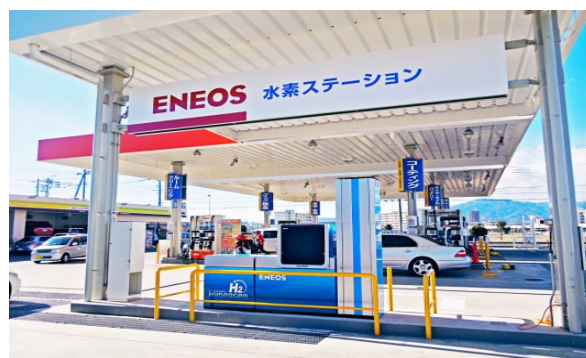
<水素充填機(手前)とガソリン計量機(奥)の設置状況>
