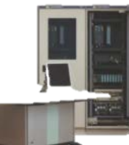
監視制御設備
