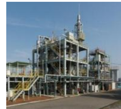
汚泥焼却システム
