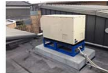
屋上設置プロパンガス発電機(9kVA)
