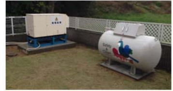
設置した自家発電機とLPガスバルクタンク (設置:ガステックサービス株式会社)
