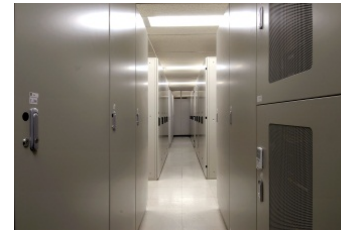
オーガス総研 東京第2データセンター
