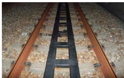
山陽新幹線逸脱防止ガード
