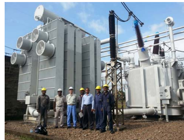
(スリランカで稼働中の当社製大型変圧器)
