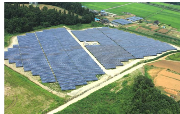
LSつくば房内発電所
