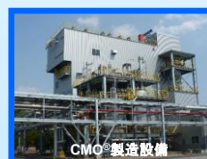
CMO®製造設備
