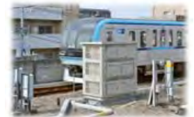
駅舎補助電源装置
