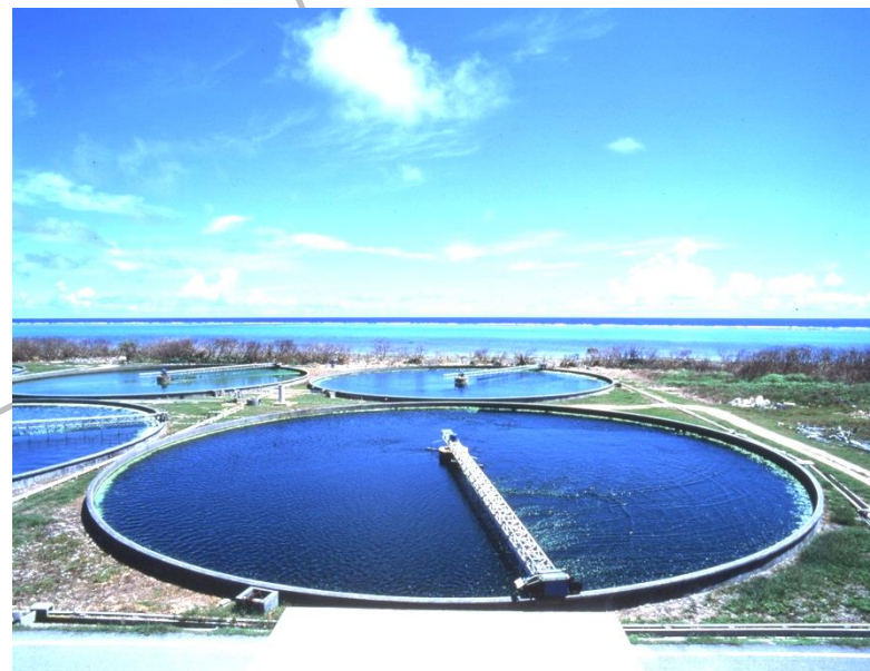
2005年当時の設備(現在は違う設備) 実証 @ 沖縄県石垣島
