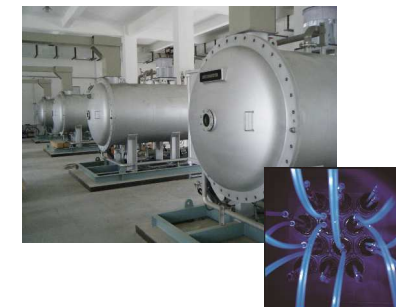
■ オゾン処理システム
