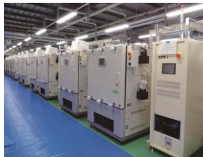
充放電試験装置
