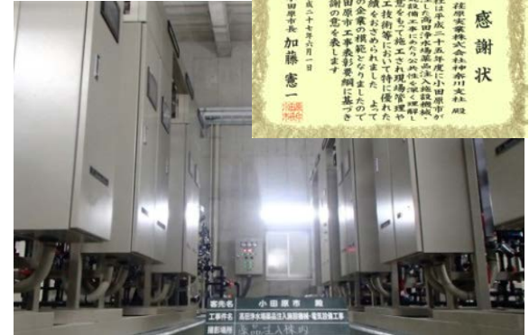
各薬品の注入設備
