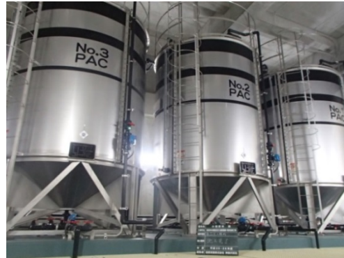
PAC (凝集剤) 薬品タンク
