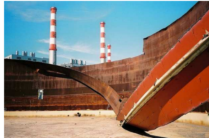
火力発電所(リンゴ皮むき工法)
