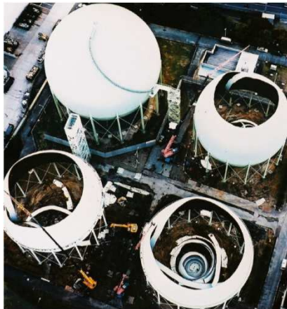
ガスホルダー(リンゴ皮むき工法)
