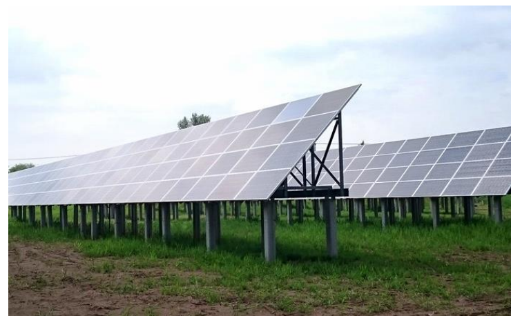
▲ 太陽光発電所
