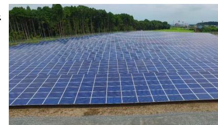
ハル水戸太陽光発電所
