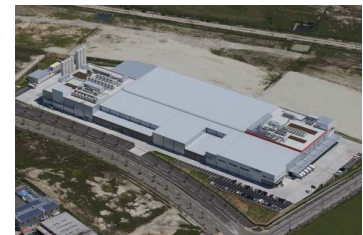
(仮称)株式会社武蔵野フーズ カムス神戸工場新築工事(兵庫県)
