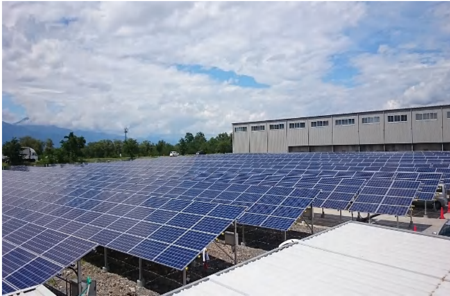
【長野 小宮0.6MW】 2015年7月稼働
