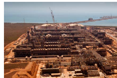
初出荷を間近に控えたゴーゴンLNGプロジェクト
