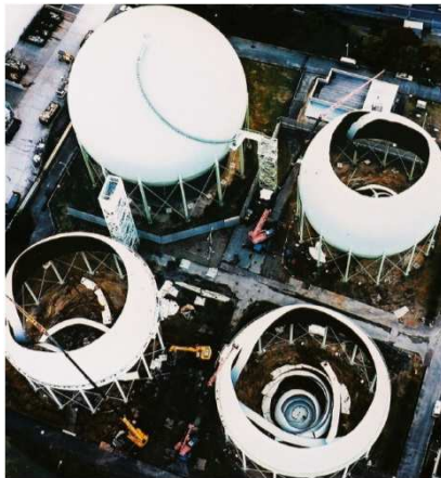
ガスホルダー（リンゴ皮むき工法）
