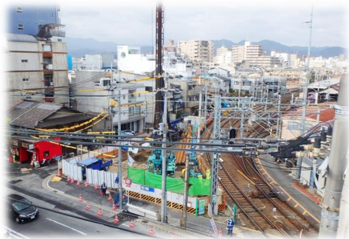
建設が進む「新京福西院ビル（仮称）」と 嵐電西院駅（嵐山方面行きのりば）
