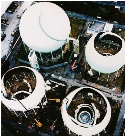
ガスホルダー（リンゴ皮むき工法）
