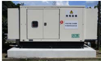
非常用発電機 (設置: ガステックサービス様)
