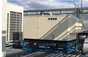
屋上設置発電機
