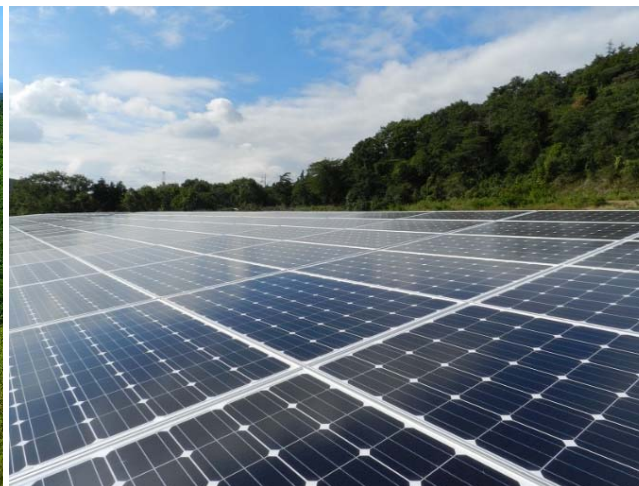
いちご桐生奥沢ECO発電所(1.33MW)
