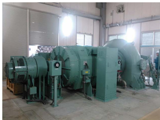
水車発電機外観
