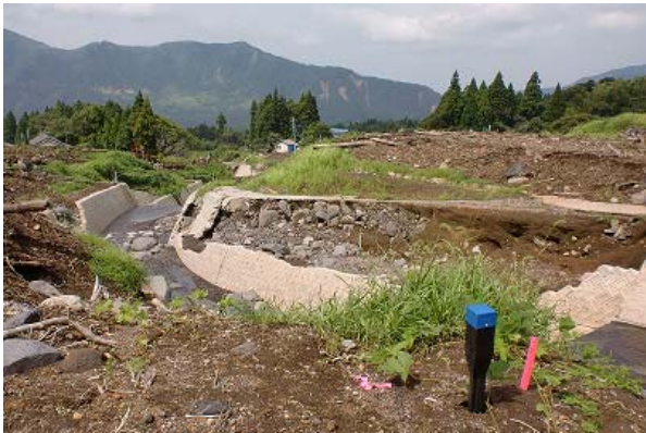
熊本県阿蘇地域に設置した崩壊検知センサー（青黒杭部分）
