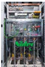
電力変換システム
