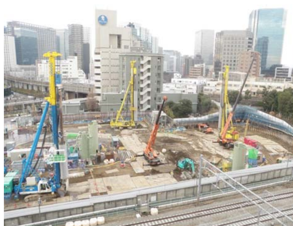
北品川非常口及び変電施設
