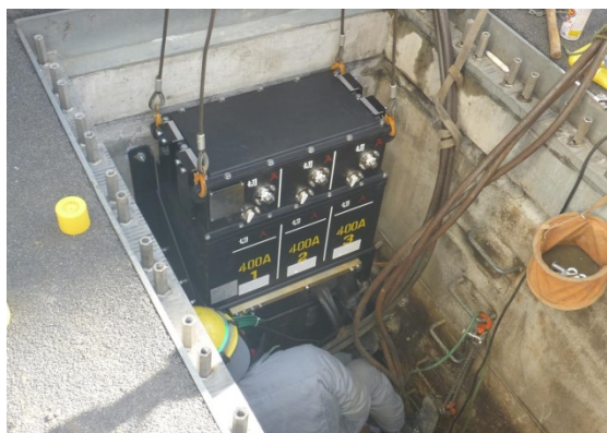
三回路真空多回路開閉器(地下孔に設置)
