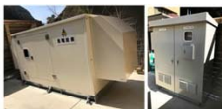
LPガス自家発電機(60kVA)と屋外制御盤
