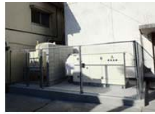
LPガス自家発電機(75kVA)と 災害バルク貯槽(1t)
