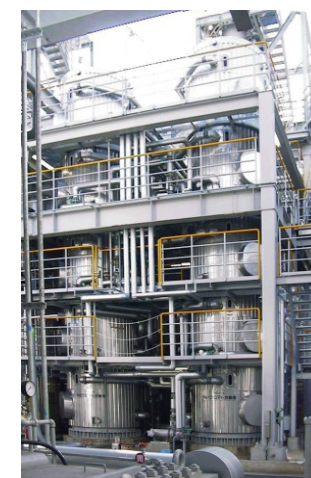
クロマト分離設備
