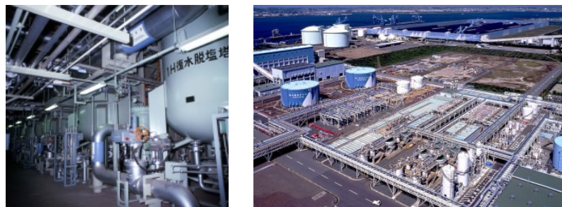
発電所向け水処理
