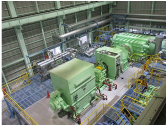
苅田工場の排熱発電設備
