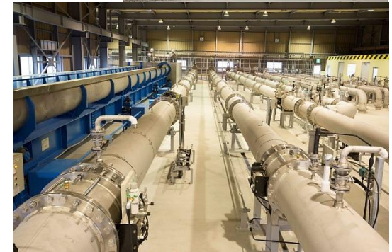
新実流量試験設備 (当社那須工場内)
