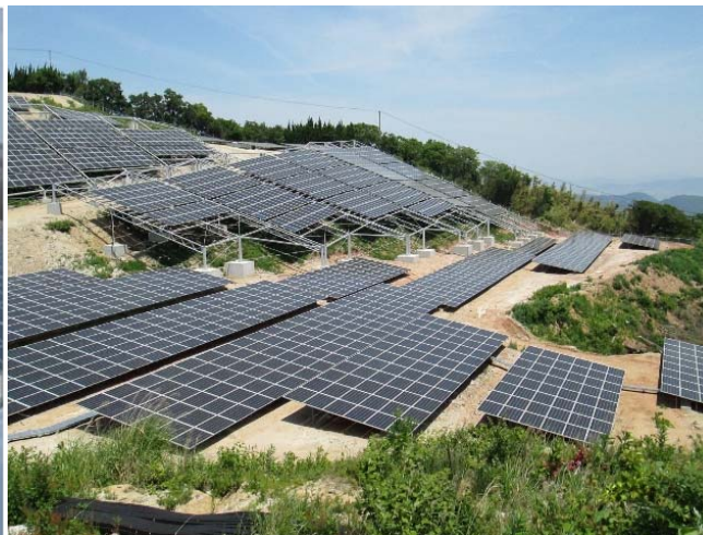
いちご高松国分寺町新居ECO発電所 (香川県高松市)
