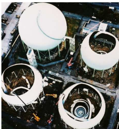
ガスホルダー（リンゴ皮むき工法）
