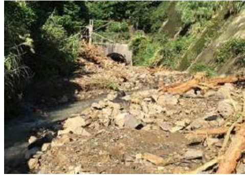
■日豊本線 津久見～日代間 土砂流入
