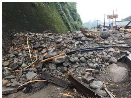
■ 日田彦山線 筑前岩屋駅構内 土砂流入
