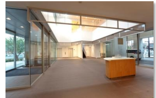
シート製の防煙垂れ壁「ケムストップ」を設置した1Fフロア
