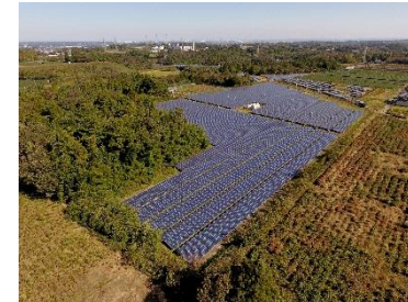
LS三重四日市発電所 パネル出力：1,984.50kw
