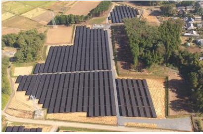
LS桜川中泉発電所 パネル出力：2,698.24kw
