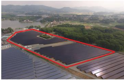
LS桜川2発電所 パネル出力：2,627.52kw
