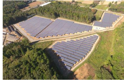
LS桜川4発電所 パネル出力：2,421.12kw
