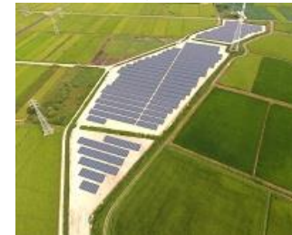
S-16 LS稲敷荒沼1発電所
