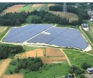
S-12 LSつくば房内発電所
