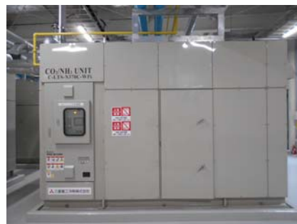
ノンフロン冷凍機 (マルハニチロ物流 出水物流センター)
