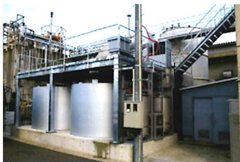
バイオガス発電設備
