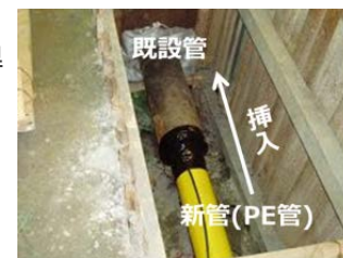
古い導管の中に、新しいPE管を入れ込むインサージョン工法
