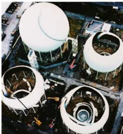
ガスホルダー（リンゴ皮むき工法）
