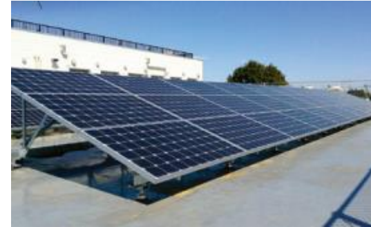
太陽光エネルギーの活用により CO2を年間約9,050kg 削減
