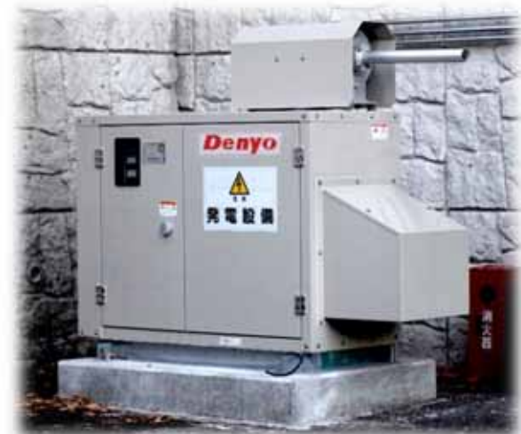
ホテルに設置されている防災用自家発電装置
