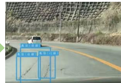
道路の亀裂・補修状況の確認
