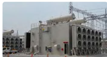
国内変電所 位相調整器納入 (2017年8月)
