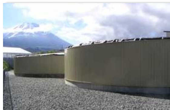
バイオガスプラント
