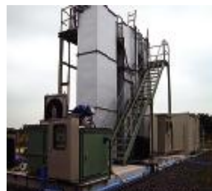
共同研究実験設備全景 (JS技術開発センター内)
